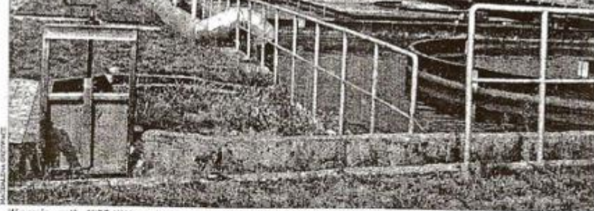
W czasie upałów WOD-KAN ma dużej przetworzyć cuchnący preparat w magazynach rotacyjnych na terenie oczyszczalni. To ograniczy rozprzestrzenianie się odoru
